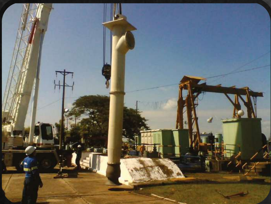
Bomba de Condensado vertical centrifuga de 8 etapas, 1760 rpm, caudal 275 GPM. REF. VTP 18028. Worthintong Central Termoeléctrica
